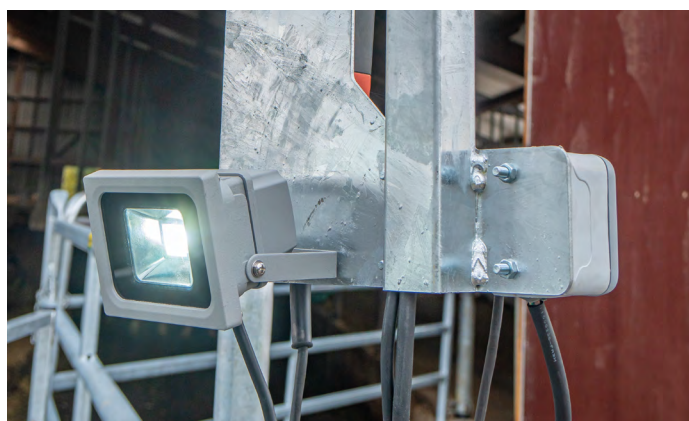
Tomas de corriente e iluminación LED
